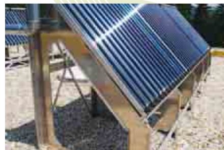
I telai di sostegno con inclinazioni diverse sono spesso usati per gli impianti termici solari.
