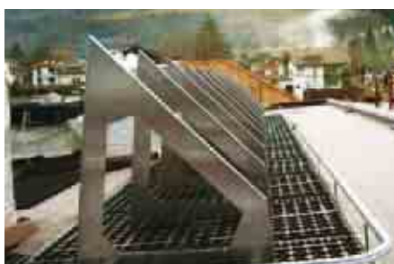
Telaio di 45° per impianti termici solari su una superficie di montaggio con inclinazione di 5°.
